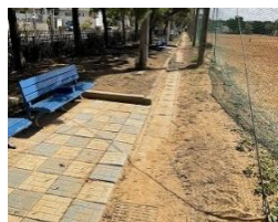
▲多目的広場側溝のつまり
