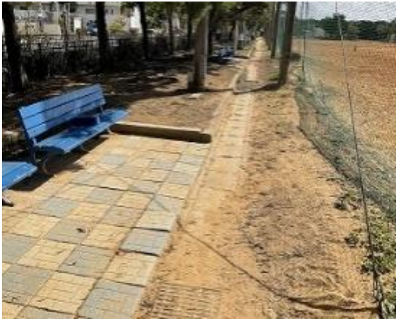
▲ 多目的広場側溝のつまり
