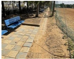
▲多目的広場側溝のつまり
