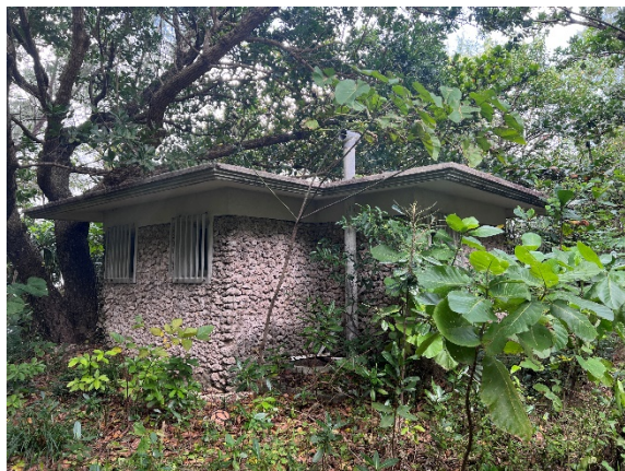
老朽化し、使用されていないトイレ
