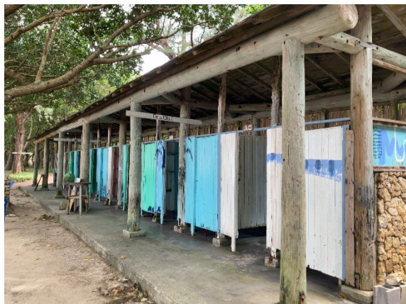
老朽化したシャワー施設
