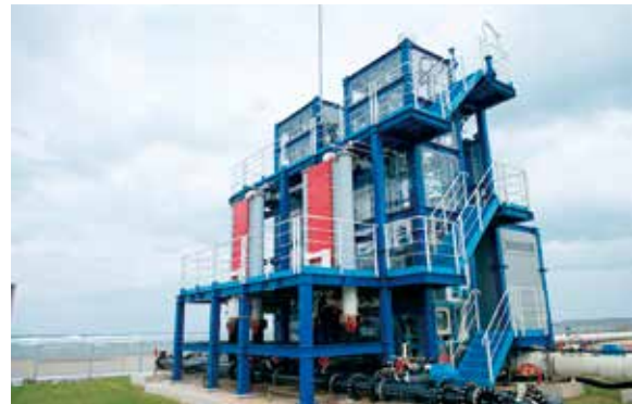
海洋温度差発電施設
