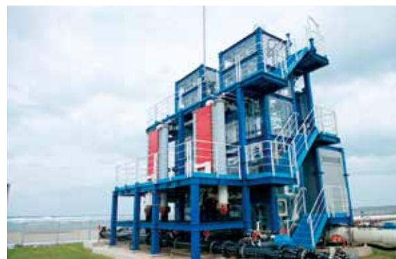
海洋温度差発電施設
